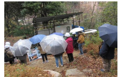
水車・発電機前
